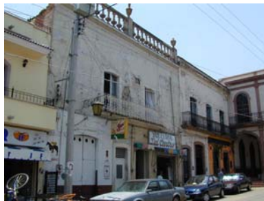
▶ Adecuaciones deficientes en fincas patrimoniales.
